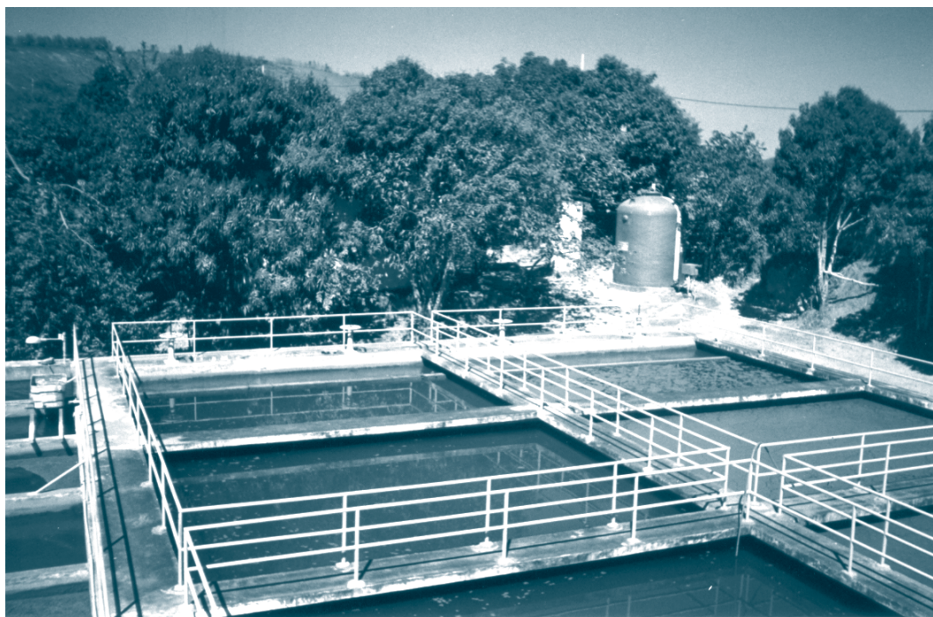
Figura 2.25 – Qualidade da água visivelmente distinta em séries paralelas de decantadores, provavelmente por aplicação não homogênea do coagulante e distribuição não uniforme do fluxo
