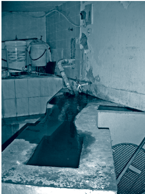
Figura 2.19 – Exemplo de unidade inadequada de mistura rápida (calha Parshall): instalações e controle precários da mistura rápida e coagulação
