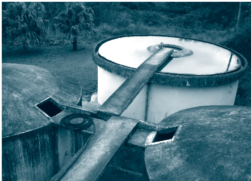
Figura 2.28 – Floculador de bandejas ao centro de um decantador circular de fluxo radial, dois filtros rápidos em paralelo, de difícil acesso para operação e manutenção, ETA de pequeno porte, antiga, com operação e manutenção precárias
